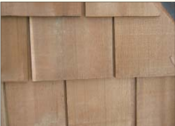
Estas uniones están instaladas mejor, hay menos alineamiento de las uniones.
