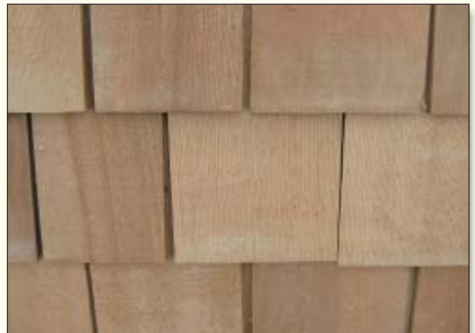
Estas uniones concuerdan con las de la segunda línea de abajo. Esto es muy malo ya que si la shake se quiebra el techo goteará.
